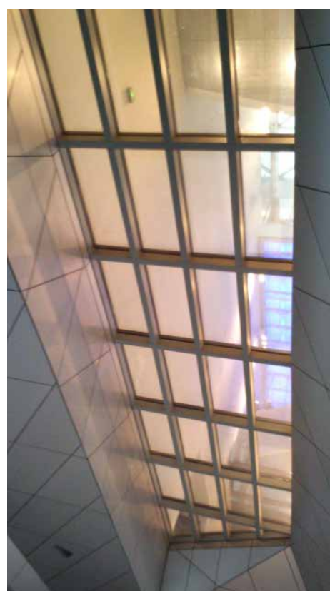
Musée des Confluences Plancher vitré coupe-feu vue de dessous Lyon (69)
